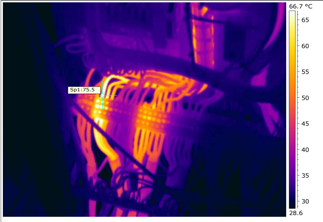
Calentamiento en las bornas del cuadro de climatización del Sótano - 4 Calentamiento provocado por la sobrecarga de la línea y a la falta de sección de la borna
